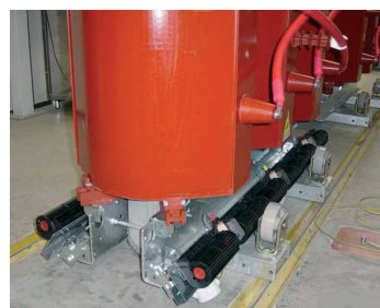
Вентилятор принудительного охлаждения (позволяет кратковременно увеличить мощность трансформатора на 40%)
