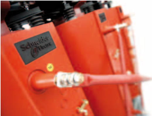
Collegamenti lato MT.
