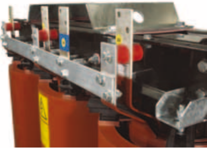
Collegamenti lato BT.
