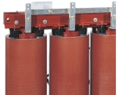
Контактные площадки НН
